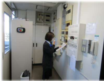
← 館内非常放送
