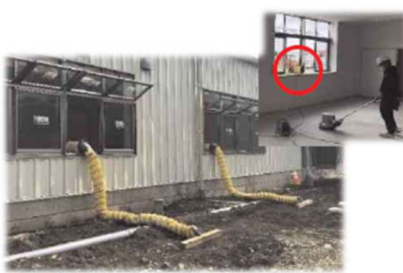
送風機を稼働し、換気を推進
